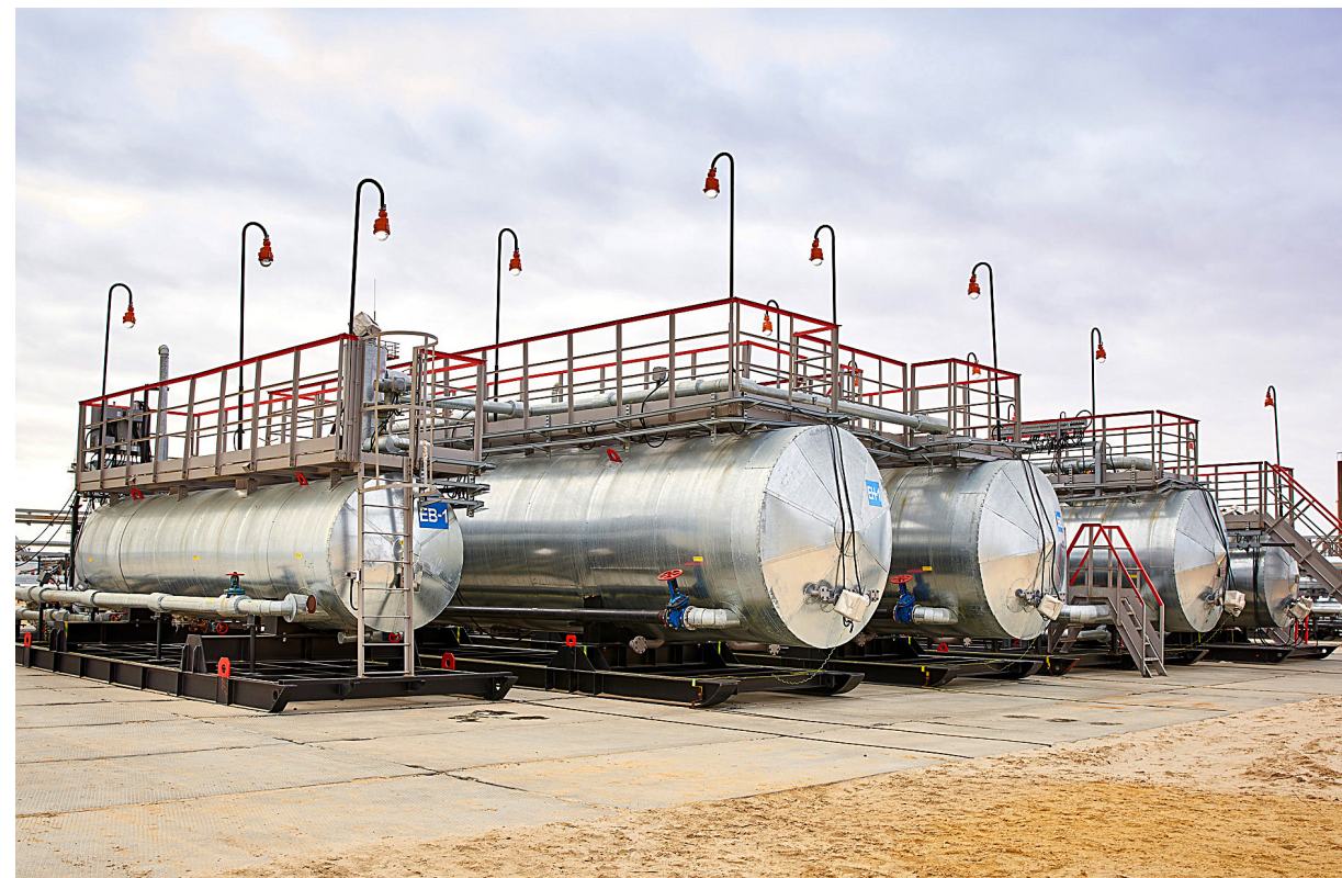
УСТАНОВКА ПОДГОТОВКИ НЕФТИ (УПН)
